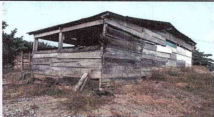
Foto1: Se observa la necesidad del mantenimiento de la Cocina.
