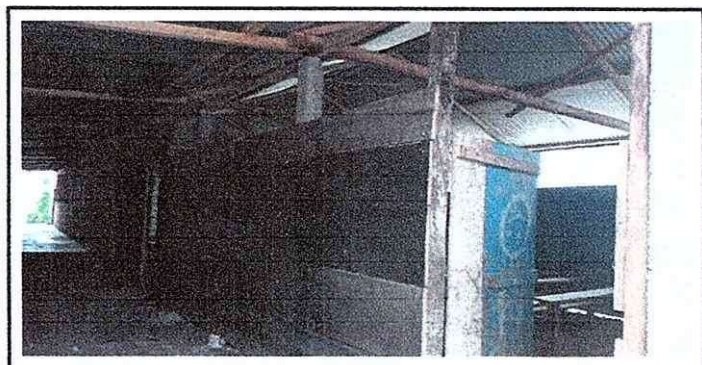
Foto 6: Interior de la cocina en mal estado.
