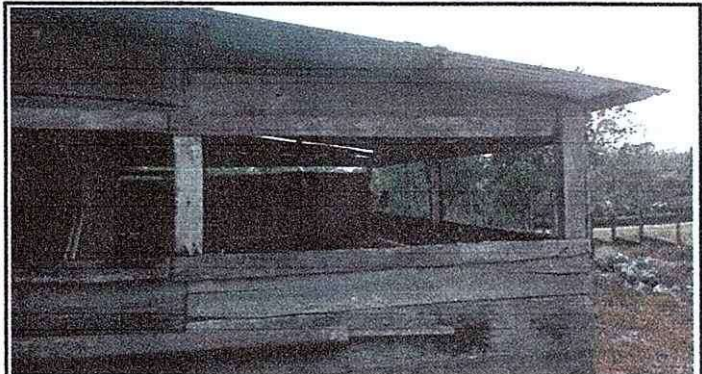
Foto 2: Mal estado del material de las paredes de la cocina.
