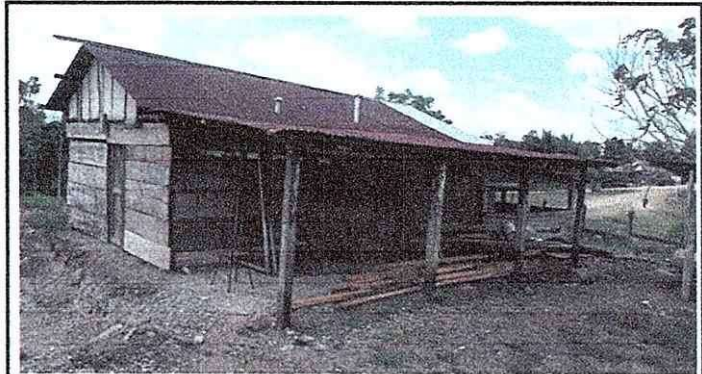
Foto 4: Area de la cocina en mal estado
