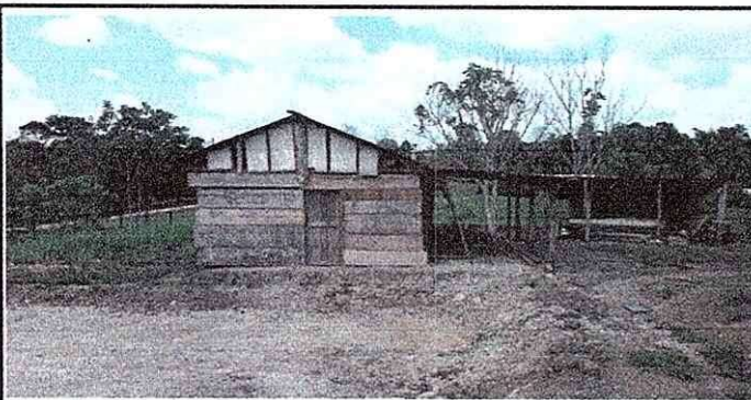
Foto 5: Condiciones inestables de la cocina.
