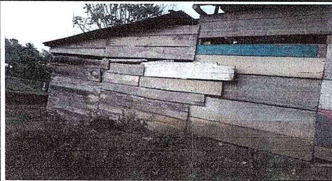
Foto 3: Condiciones inestables de las paredes de la cocina.
